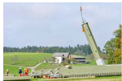
3 Non sostare sotto i carichi sospesi.
