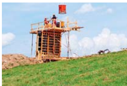
2 Mettere in sicurezza i punti a rischio caduta.
